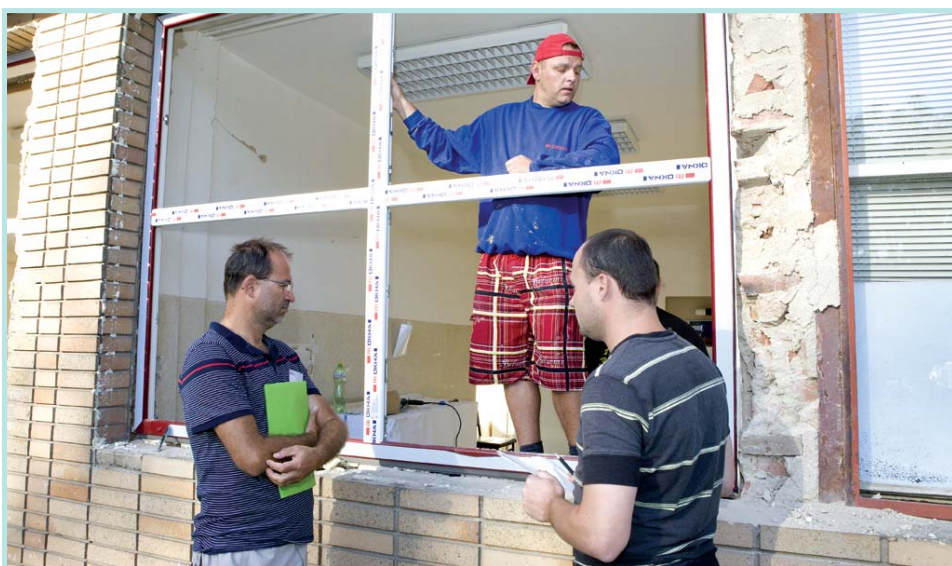
Výměna oken na interním pavilonu probíhá pod dohledem technického náměstka Ing. Bronislava Klečky.
